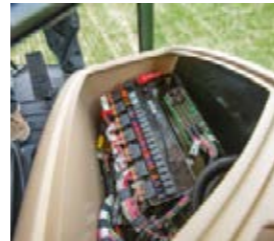
■ Diagnose-aansluitingen voor FENDIAS in de goed bereikbare zekeringenkast
